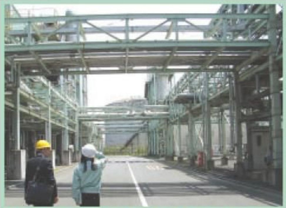
▲ 工場敷地内。巨大な建物がたくさんのパイプでつながっています。騒音やにおいはほとんどありません。
