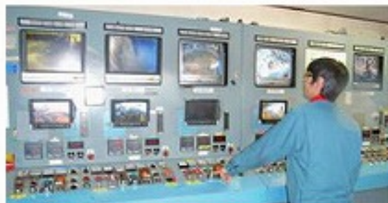
▲パルパーの様子を24時間集中管理しているコンピューター制御室。
