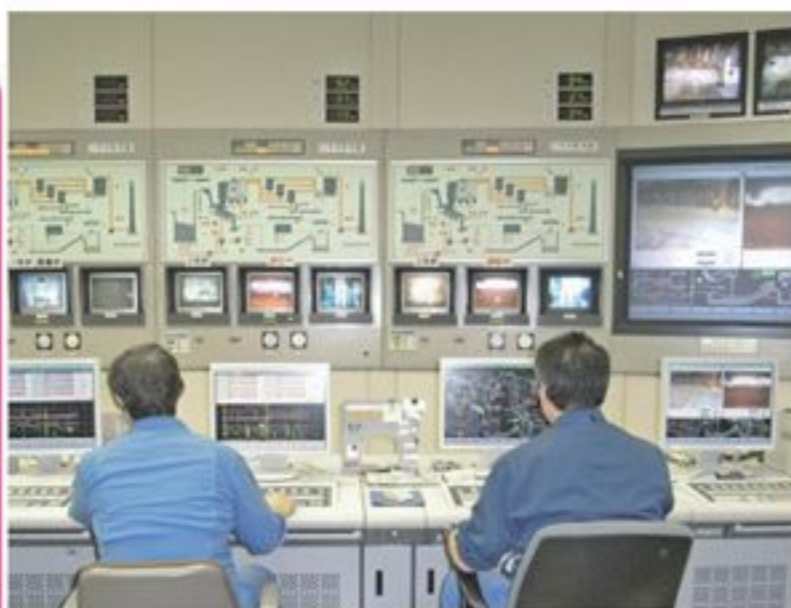
職員は2交替制で常に監視。
