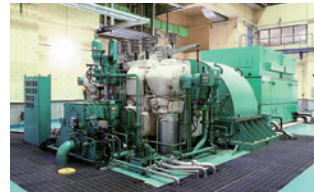
写真6：蒸気タービン発電機。3万5000KWの発電が可能で約8万世帯分に相当する。
