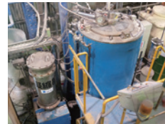
工場内に2台ある水銀蒸留装置。
